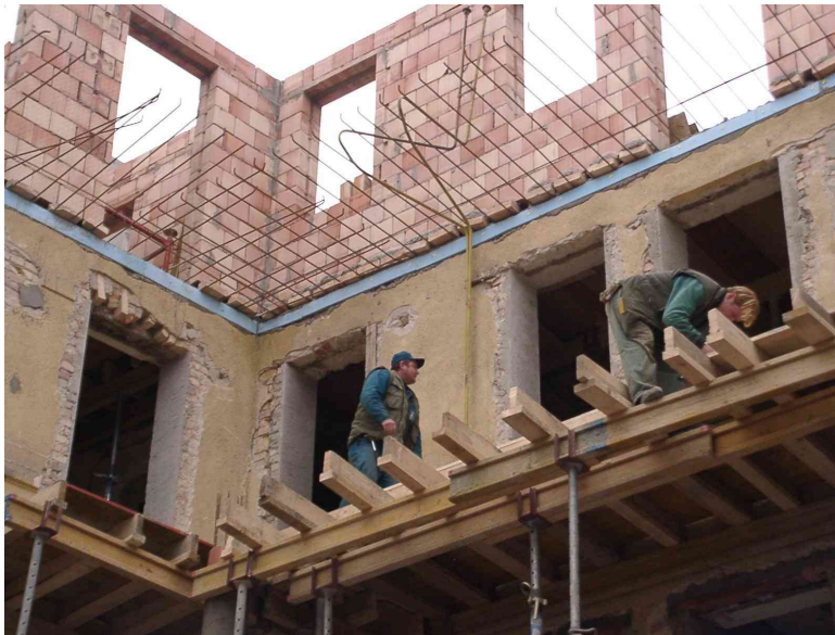
Rénovation d'un ancien bâtiment à Budapest, Hongrie. Réutilisation et adaptation d'un bâtiment en ajoutant un étage.
